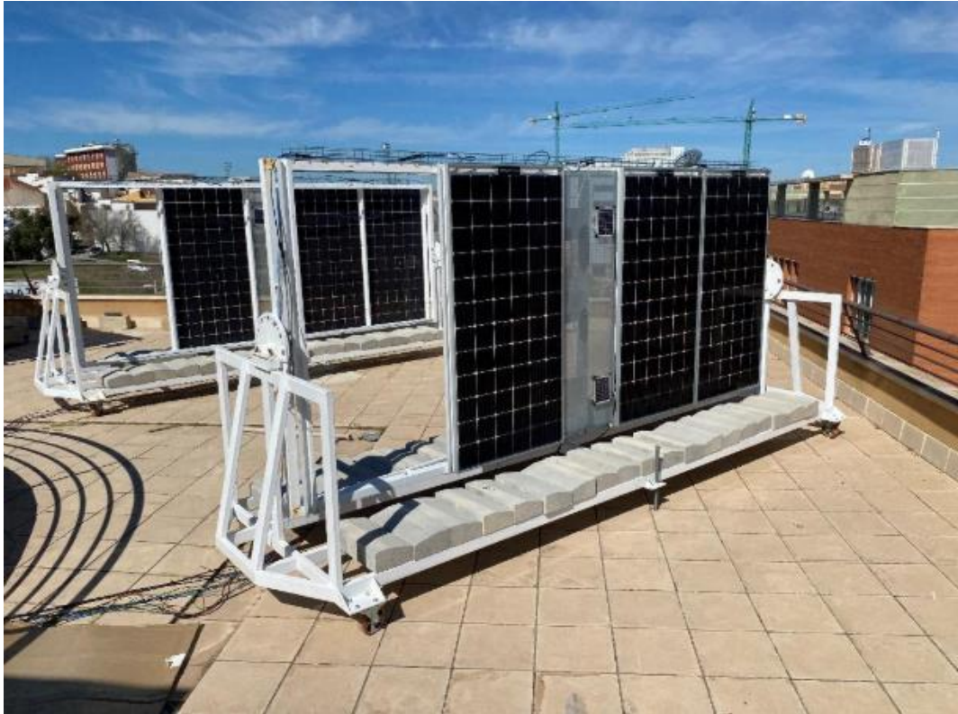
Figura 27- Instalación fotovoltaica bifacial vertical. (Sergio Contreras, 2023)
