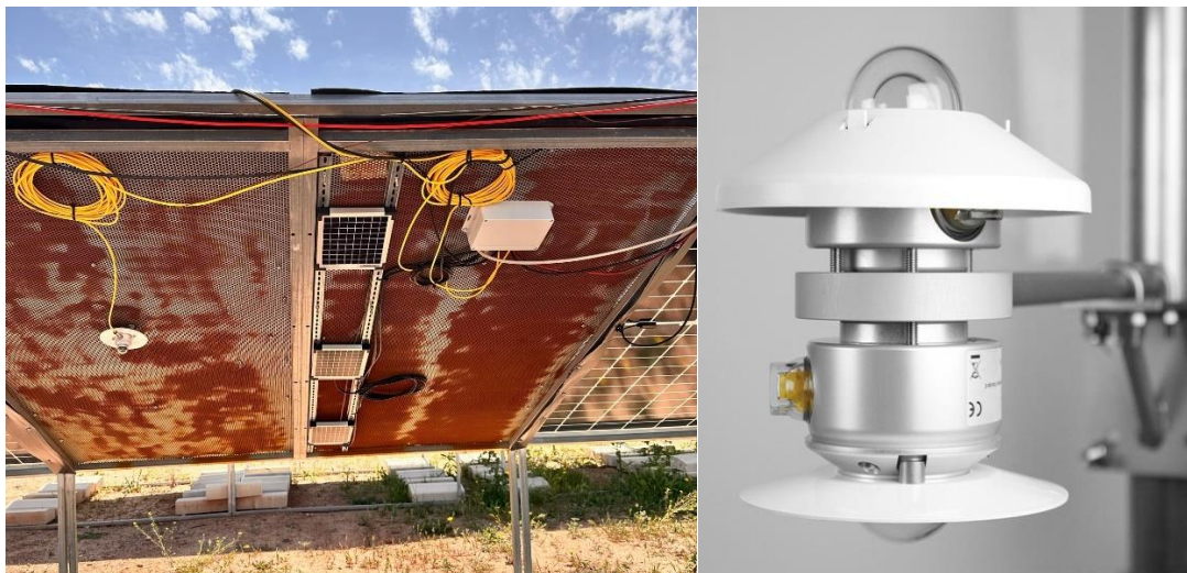
Figura 9- Sensores de irradiancia usados en la instalación
