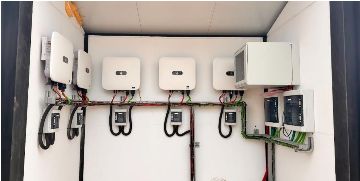
Figura 7- Caseta de inversores
