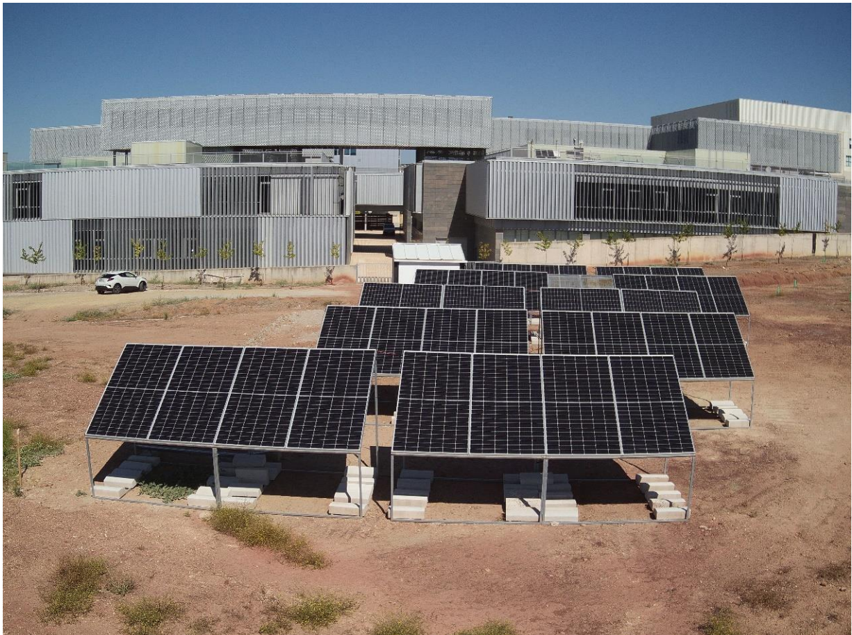
Figura 1- Vista aérea de la instalación
