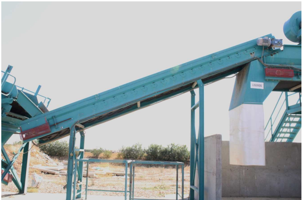
Figura 32. Fotografía de cinta transportadora CT-03.
