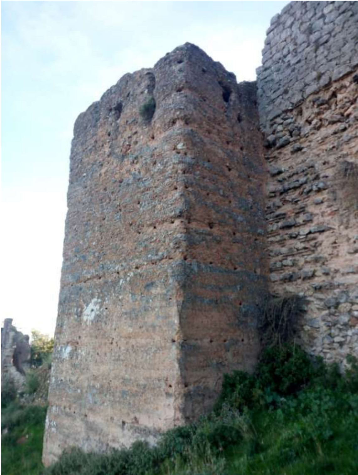
Figura 34. Restos de la torre N o 11. (Fuente: Rocío Echevarría).
