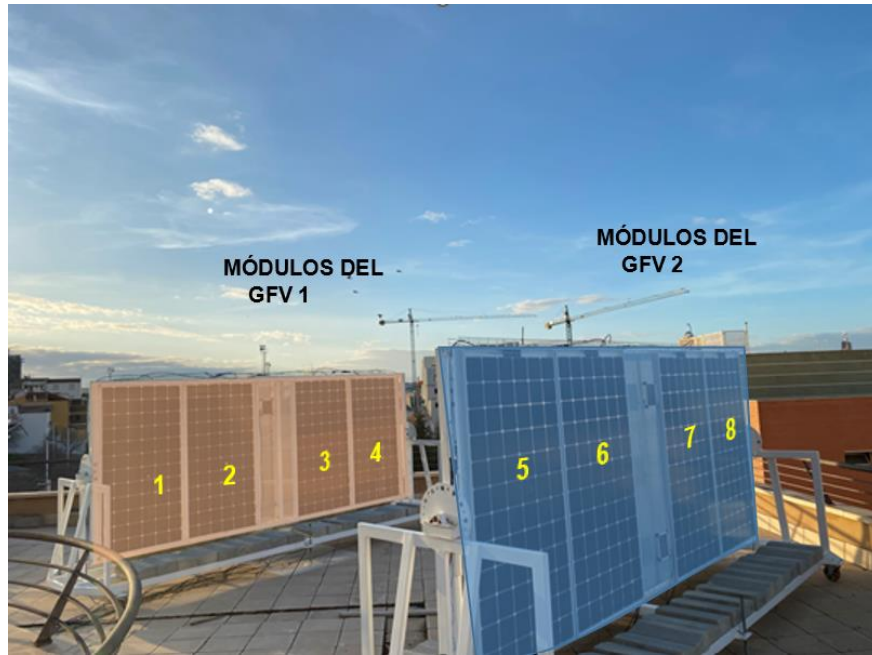
Figura 1. Ubicación y configuración del sistema fotovoltaico.
