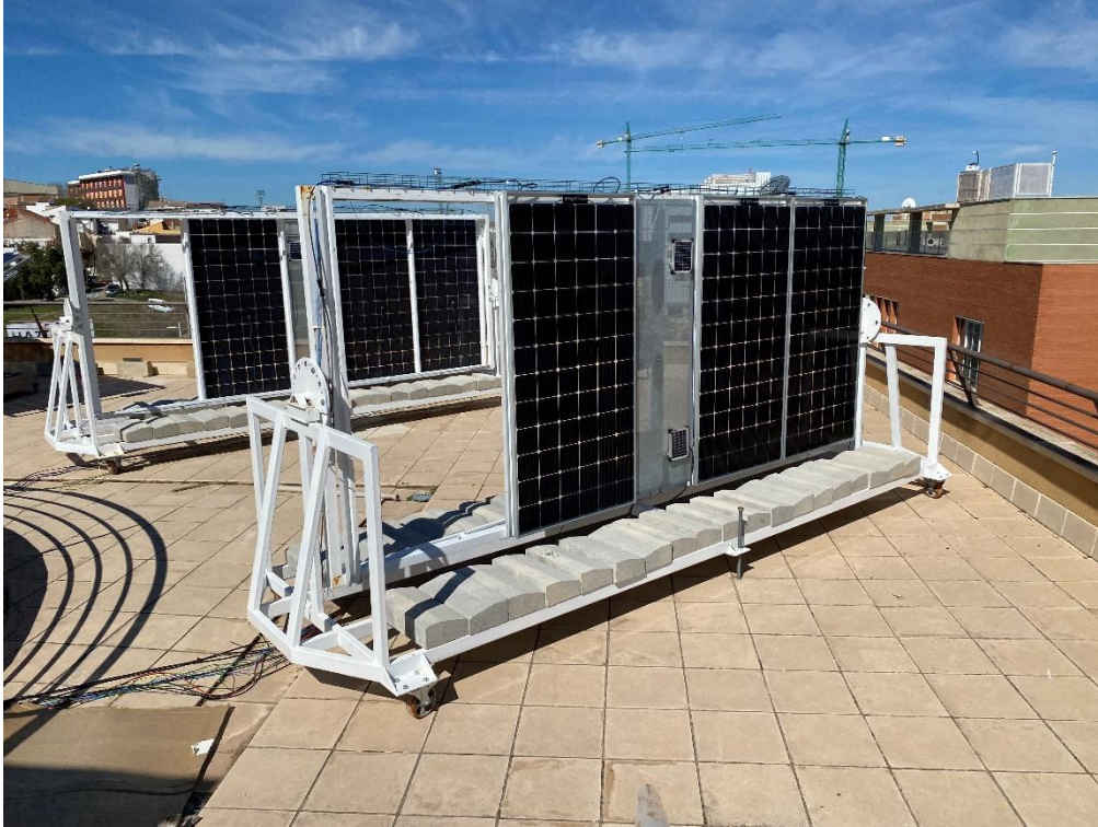
Figura 35. Configuración actual de la instalación como solución al problema de puntos calientes.
