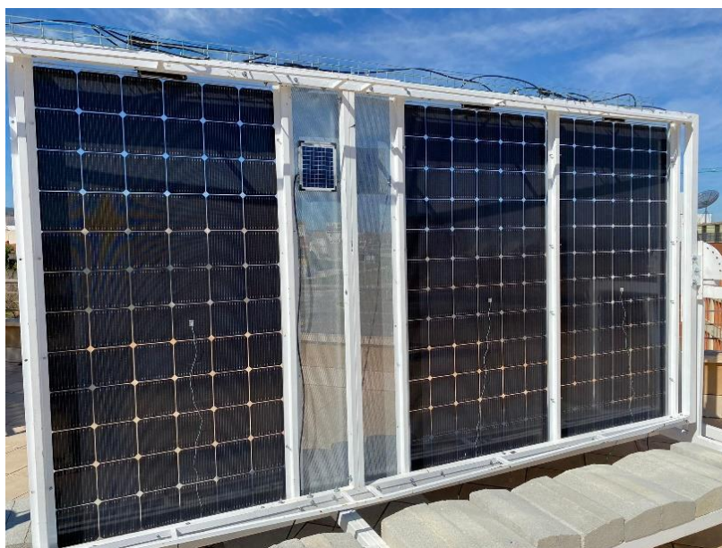
Figura 5. Sombras parciales superiores creadas por la estructura.
