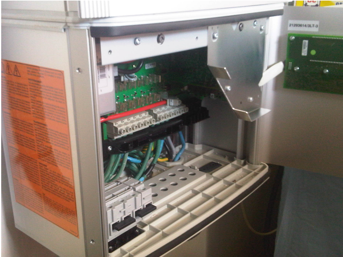
Figura 6. Detalle de conexión de Strings y protecciones del inversor
