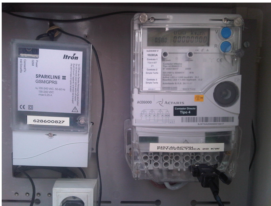
Figura 8. Detalle del contador y equipo de telemedida
