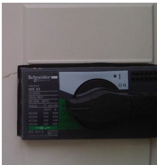
Figura 5. Interruptor general de corte
