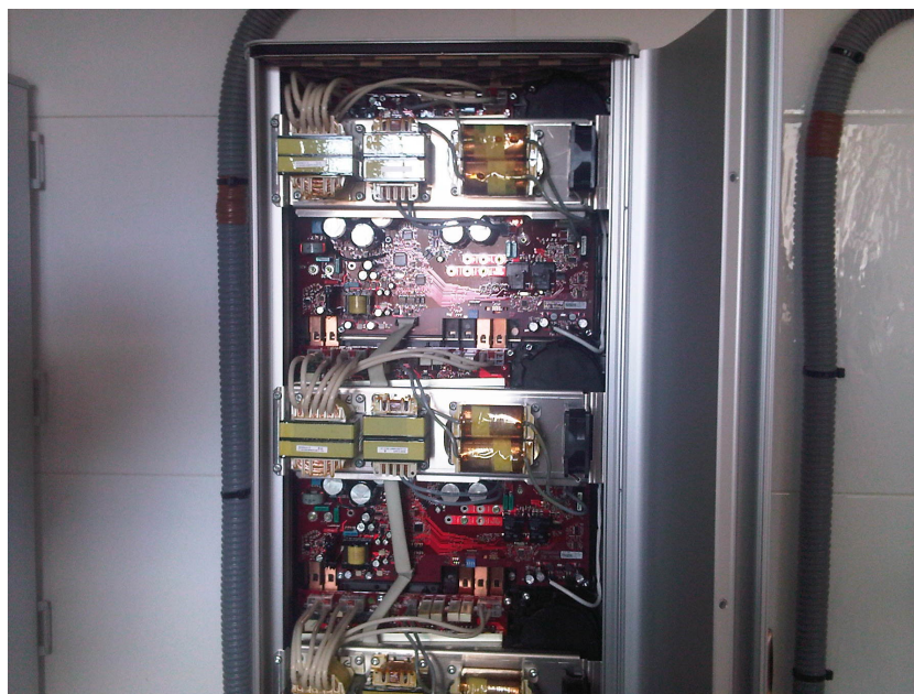
Figura 3. Detalle del interior del inversor
