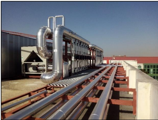
Ilustración 26. Instalación en edificio Mondragones Enfriadora 1 Fuente: propia
