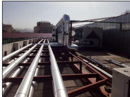
Ilustración 25. Instalación en edificio Mondragones Enfriadora 2 Fuente: propia
