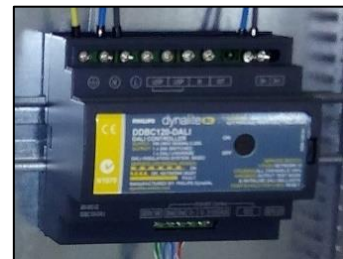
Ilustración 6 Ejemplo de controlador para alumbrado DALI. Fuente: Propia.
