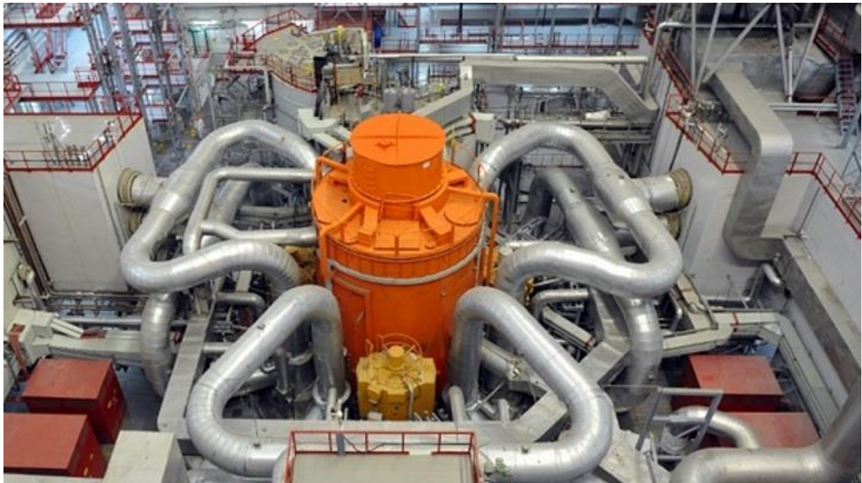
Figura 15. Reactor de IV generación BN-800. Fuente: (Rosatom, 2020)
