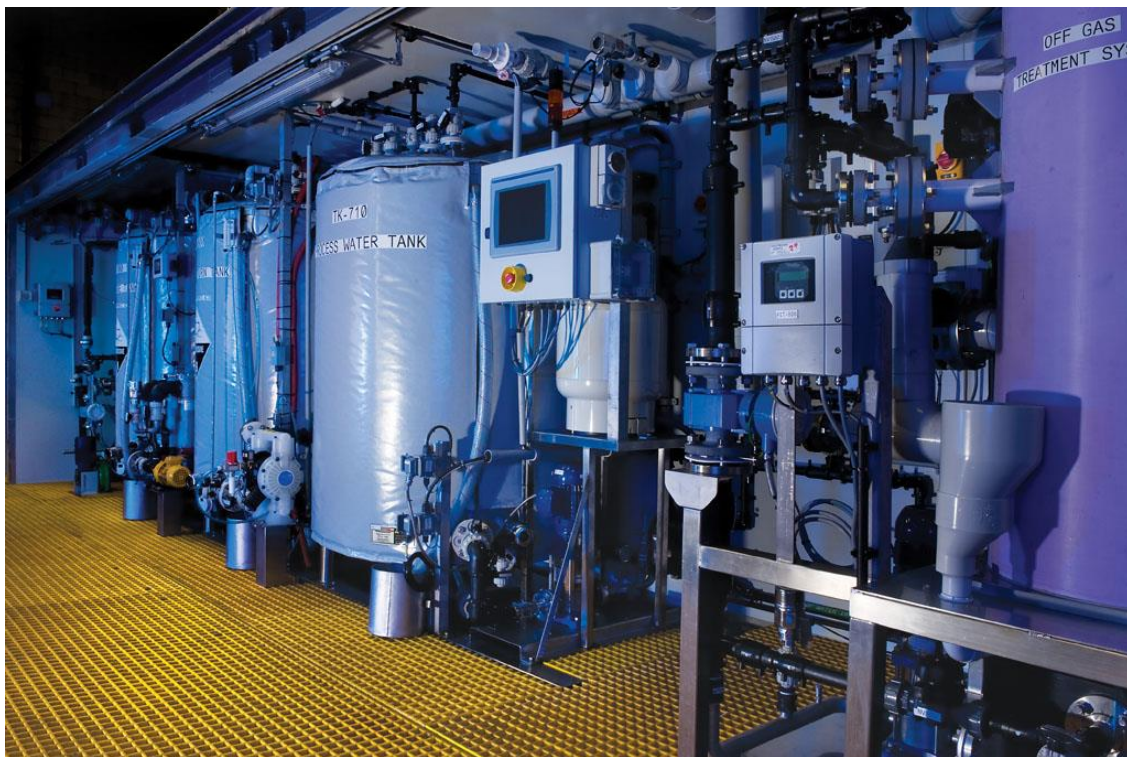
Figura 23. Planta de procesado de roca fosfórica Phosenergy. Fuente: (DevEX, 2021)
