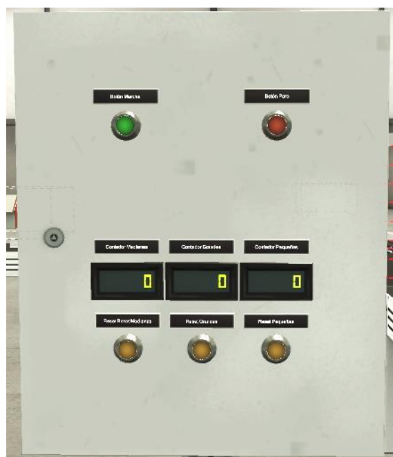
Figura 3.41. Cuadro de mandos de la estación distribuidora de cajas.
