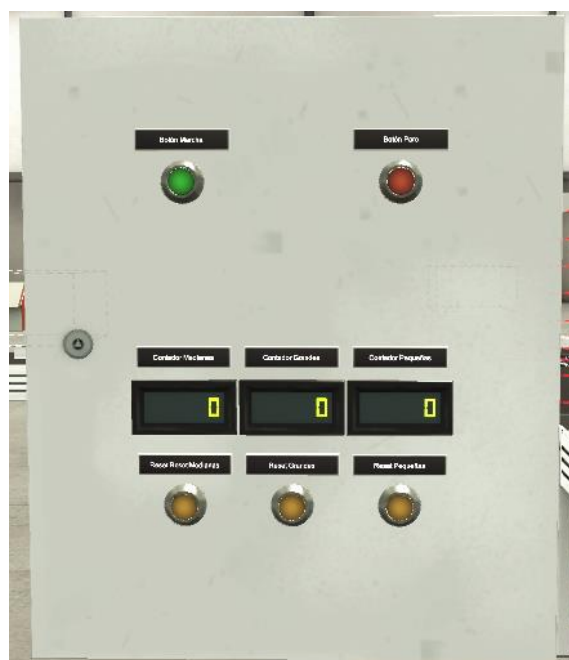
Figura 2.40. Cuadro de mandos de la estación distribuidora de cajas.
